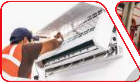
MAINTENANCE AC TAHUNAN
